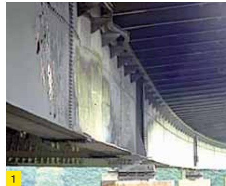
Erste Aufnahmen 2004 der Schadensstelle.
